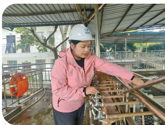
鲤鱼石水厂员工检查设备
