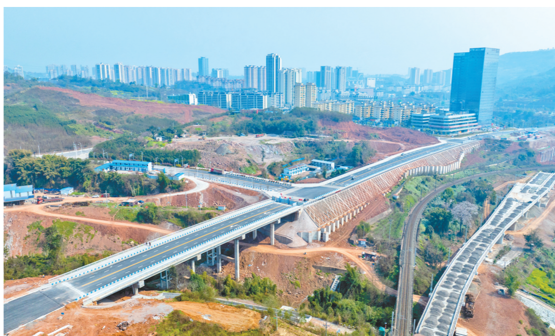
德滨路东段一期项目部分道路完成划线工作 记者 廖洋 摄
