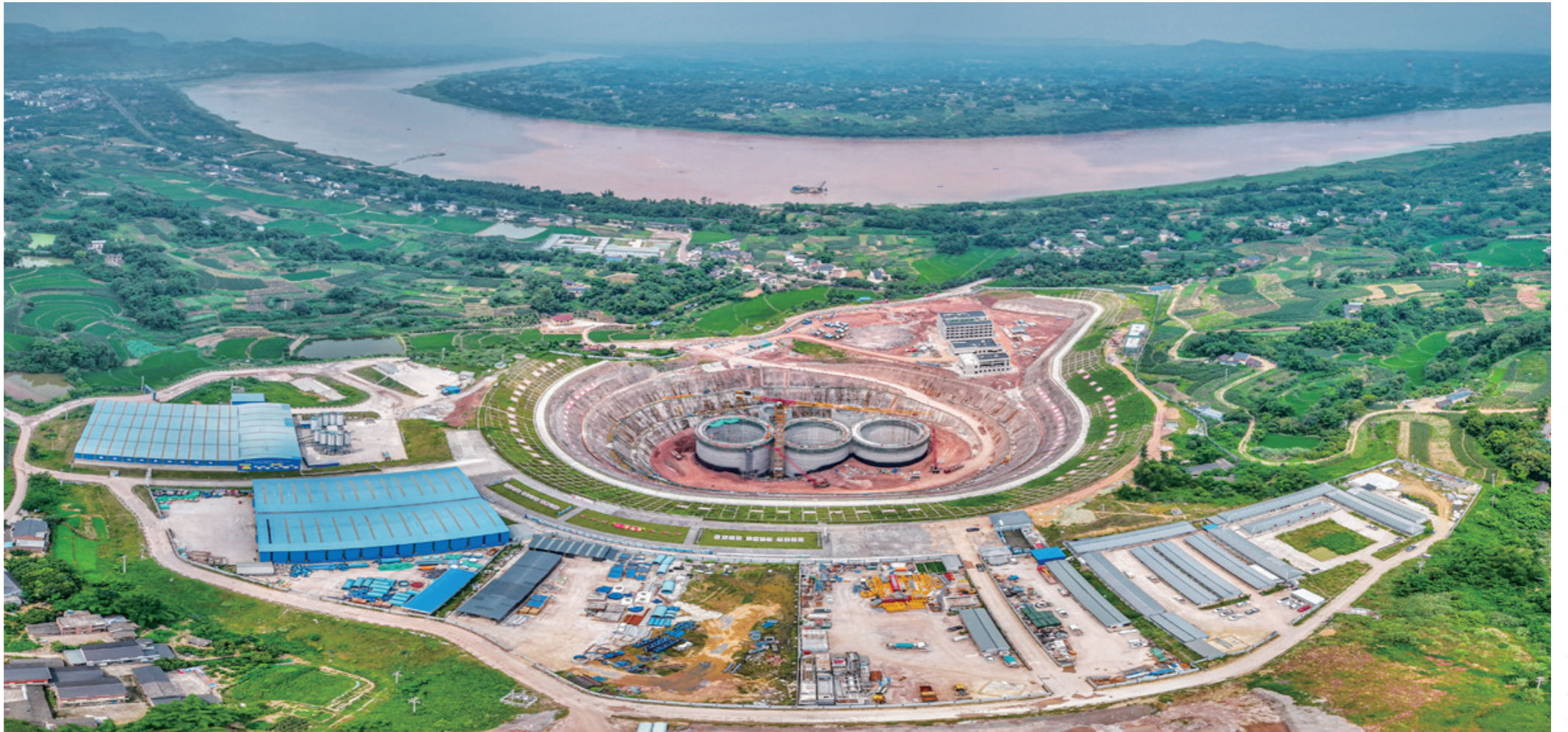
油溪镇，建设中的渝西水资源配置工程金刚沱泵站 谭文奇摄
