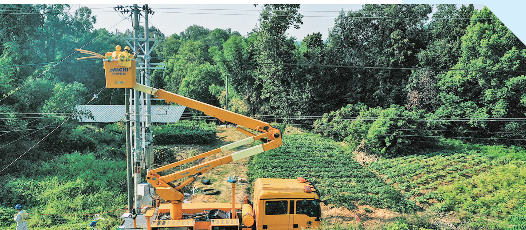
◀2024年12月10日，在油溪镇大坡村明正果园种植基地开展安全用电检查，确保柑橘采摘加工安全可靠供电。
