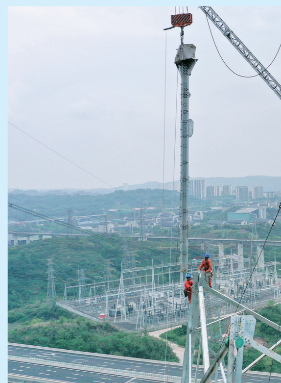
▼2024年4月17日，在圣泉街道，工作人员对铜梁1000千伏变电站至江津500千伏圣泉变电站500千伏线路进行组塔施工。
