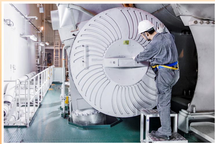
奥赛能涡轮增压工人正在检查消音器U型压力计运行情况
