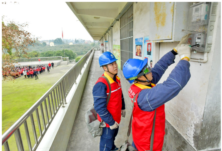
筑牢校园用电安全防线 通讯员 王化全 摄
